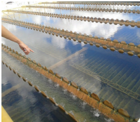
Figura 2 – Estação de tratamento Pratygy
