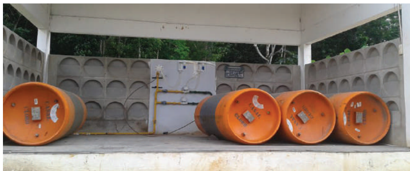
Figura 4 – Cloro utilizado no Sistema Catolé Cardoso
